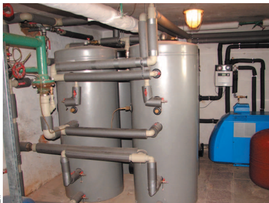
Fot. 1. Widok kotłowni olejowej i zasobników ciepłej wody po modernizacji instalacji
