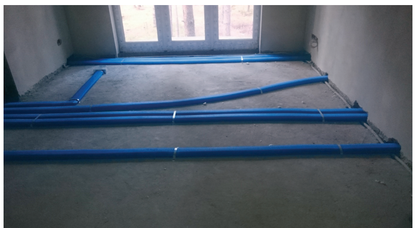
8. Przewody do wentylacji parteru, wykonane z kanałów płaskich flex ował, udało się natomiast zmieścić pod podłogą piętra
