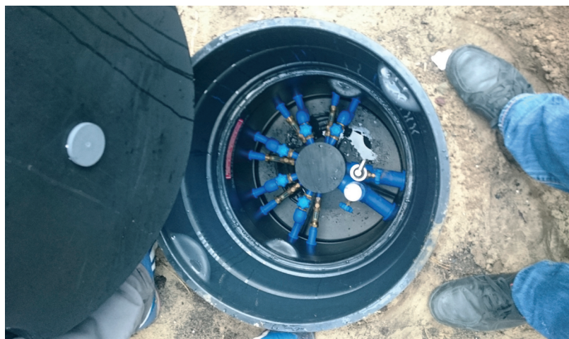
3. Studnia dla gruntowej pompy ciepła na podwórzu posesji – w studni połączone sondy gruntowe z rozdzielaczem
