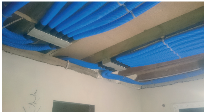
7. Przewody do wentylacji piętra budynku zostały podwieszane do sufitów pomieszczeń na piętrze
